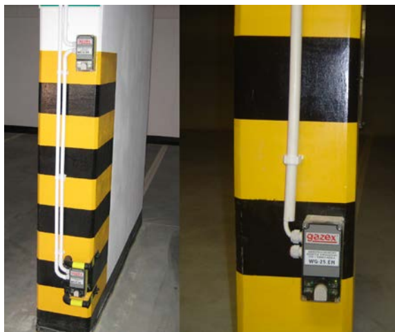
Fot. 2. Dwa różne rozwiązania detekcji CO i LPG w hali garażowej. Dwa detektory jednogazowe lub jeden detektor dwugazowy
