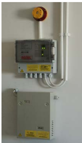
Fot. 1. Centrala i sygnalizator systemu detekcji gazu ziemnego wraz z zasilaniem rezerwowym
