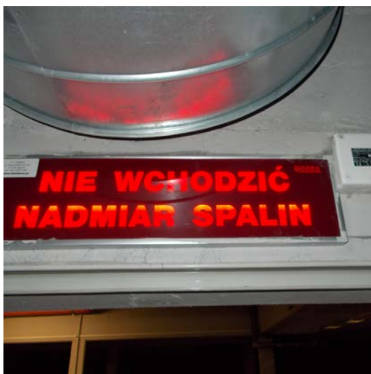
Fot. 3. Przykład podświetlanej tablicy ostrzegawczej przy wejściu do hali garażowej
