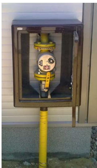
Fot. 4. Zawór elektromagnetyczny na instalacji gazowej
